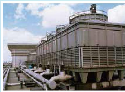
冷却塔循环系统
