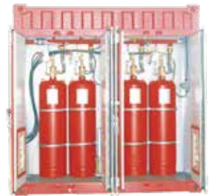
平台用七氟丙烷灭火系统
