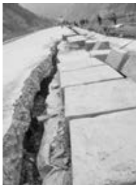
图 1-6 地震产生地裂缝
