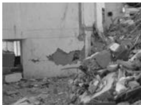
图 4-16 抗震墙的破坏
