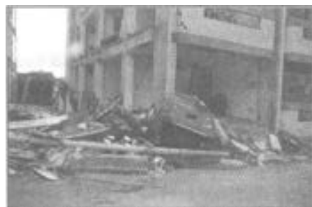
图 4-15 填充墙的破坏
