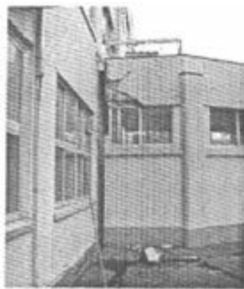
图 4-8 防震缝两侧结构单元碰撞造成的损坏
