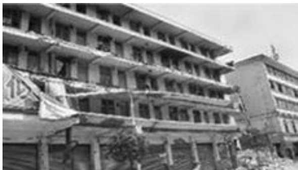
图 5-9 附属构件的破坏
