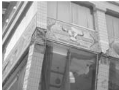
图 1-11 地震造成柱端破坏
