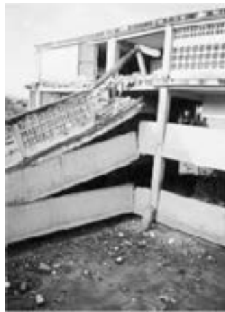
图 4-6 软弱底层房屋倒塌形式之二（底层完全倒塌）
