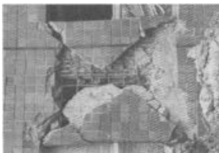
图 4-18 墙肢间连梁的破坏
