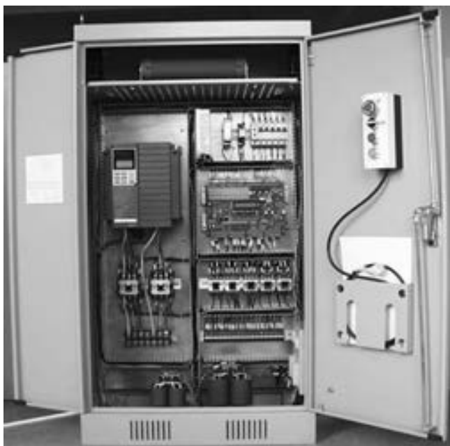
图 5-28 某电梯控制柜
