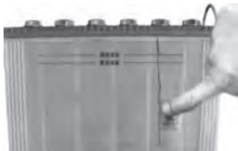
图11-39 蓄电池外壳破裂
